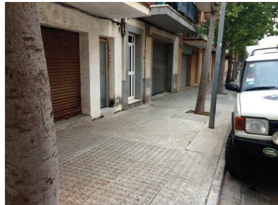
Paviment de vorera en mal estat.
