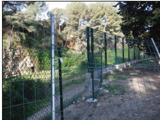
Foto 3: tram de mur caigut
