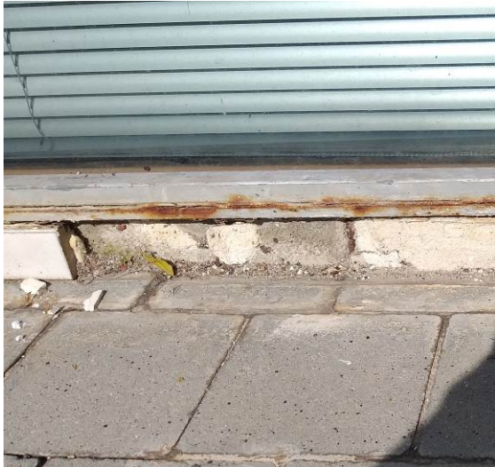
Sòcol de peces ceràmiques en mal estat
