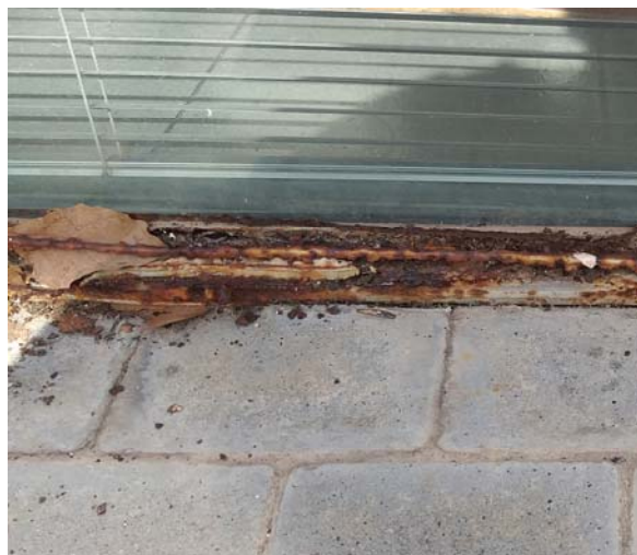
Grau E – marc amb procés de corrosió avançat
