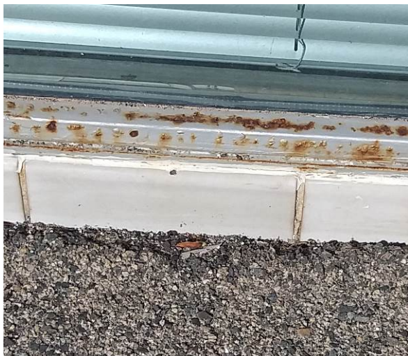
Grau D – marc amb inici de procés de corrosió
