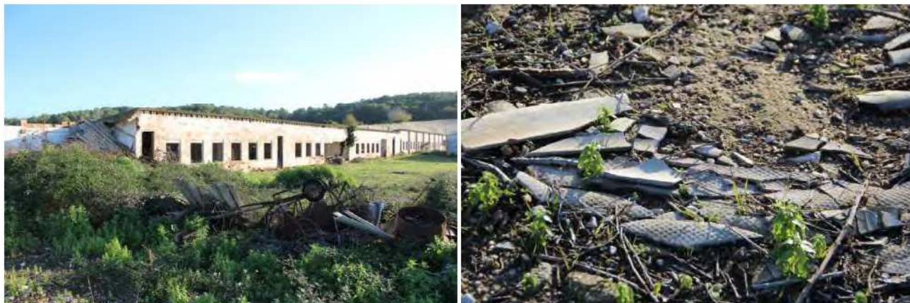
Imatge 12. Presència de residus i restes d'amiant
