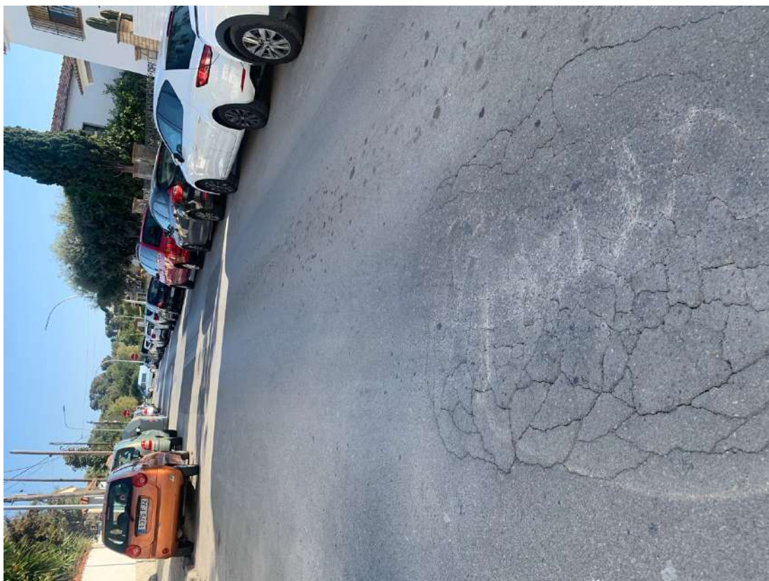
Asfalt malmès carrer Ildefons Cerdà
