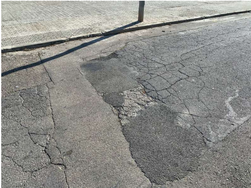
Asfalt malmès av. Mas d'en Serra
