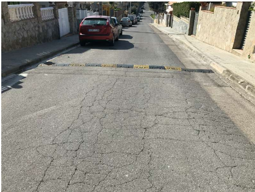
Asfalt malmès al carrer Pica d'estats
