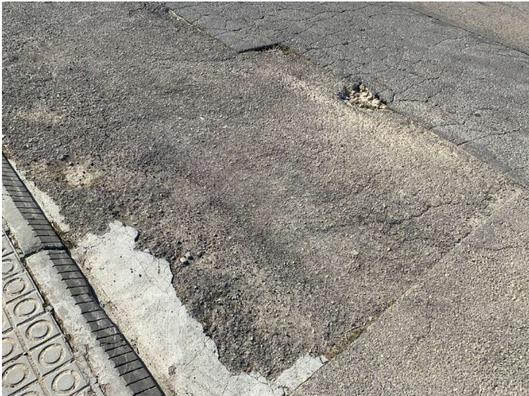
Asfalt malmès av. Mas d'en Serra
