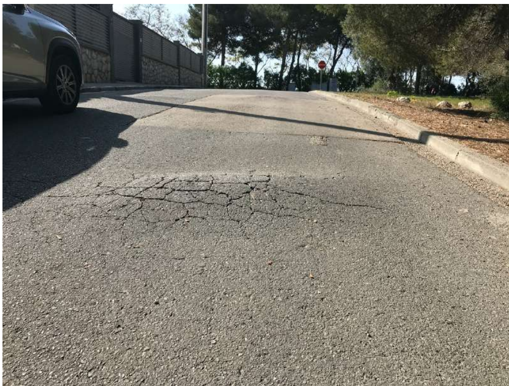
Abombament de l'asfalt
