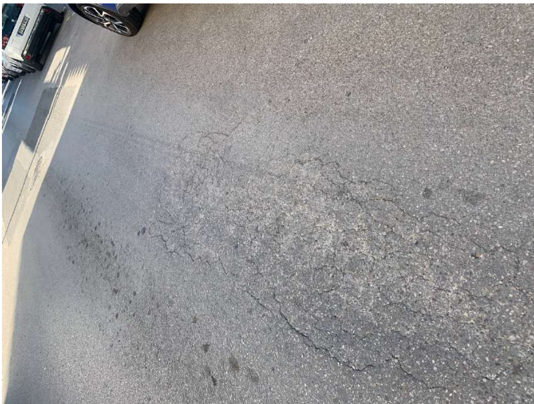
Asfalt malmès carrer Ildefons Cerdà
