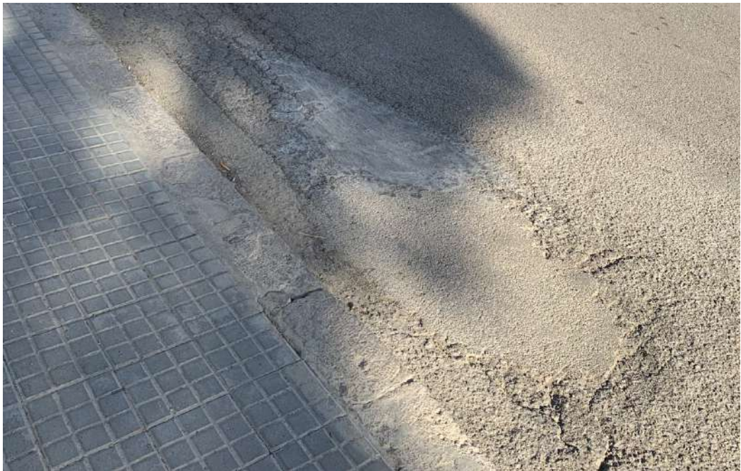
Asfalt malmès carrer Eduard Maristany
