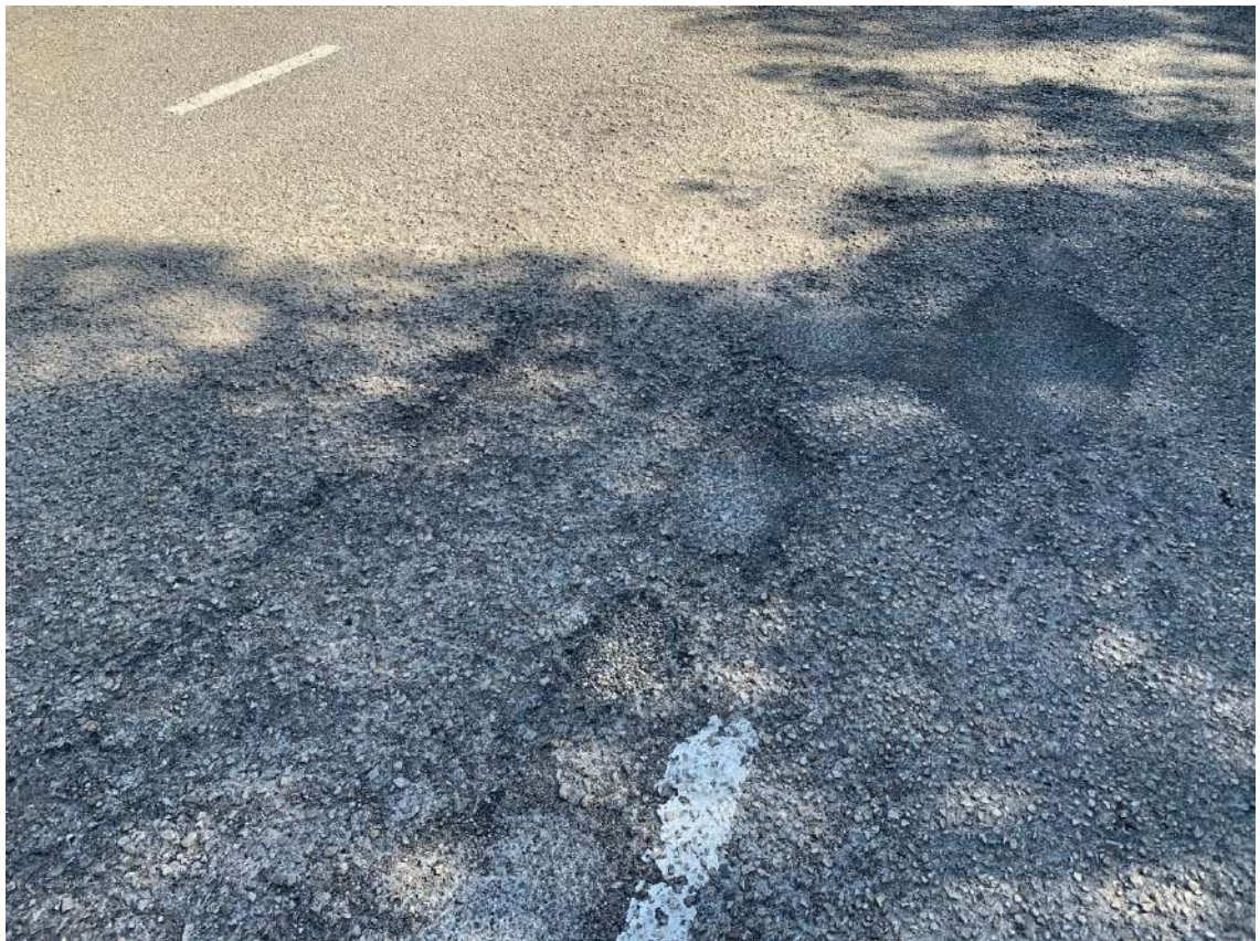
Asfalt malmès al carrer Carinyena
