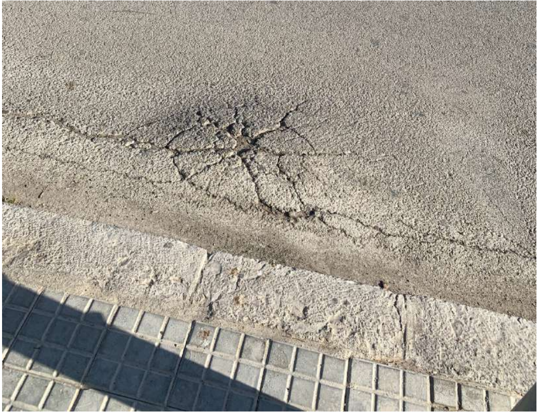
Asfalt malmès carrer Eduard Maristany
