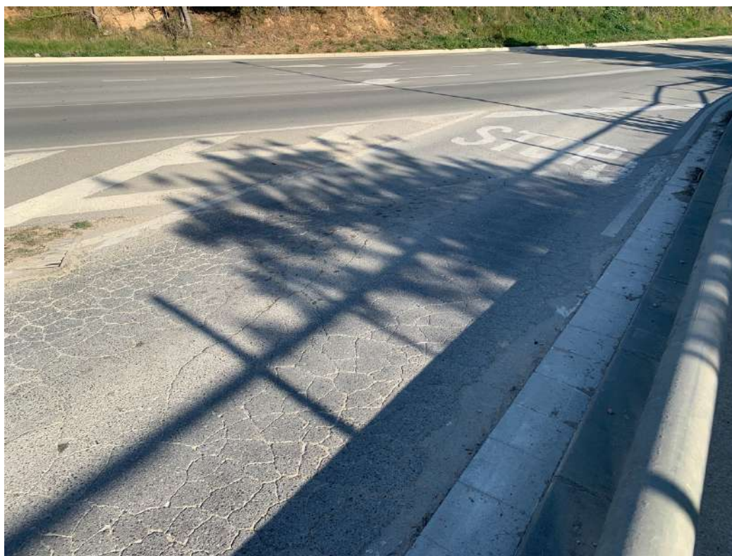
Asfalt malmès rotonda Sant Camil
