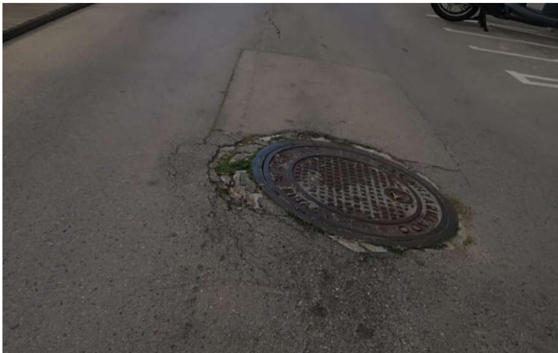
Asfalt malmès carrer Torreta
