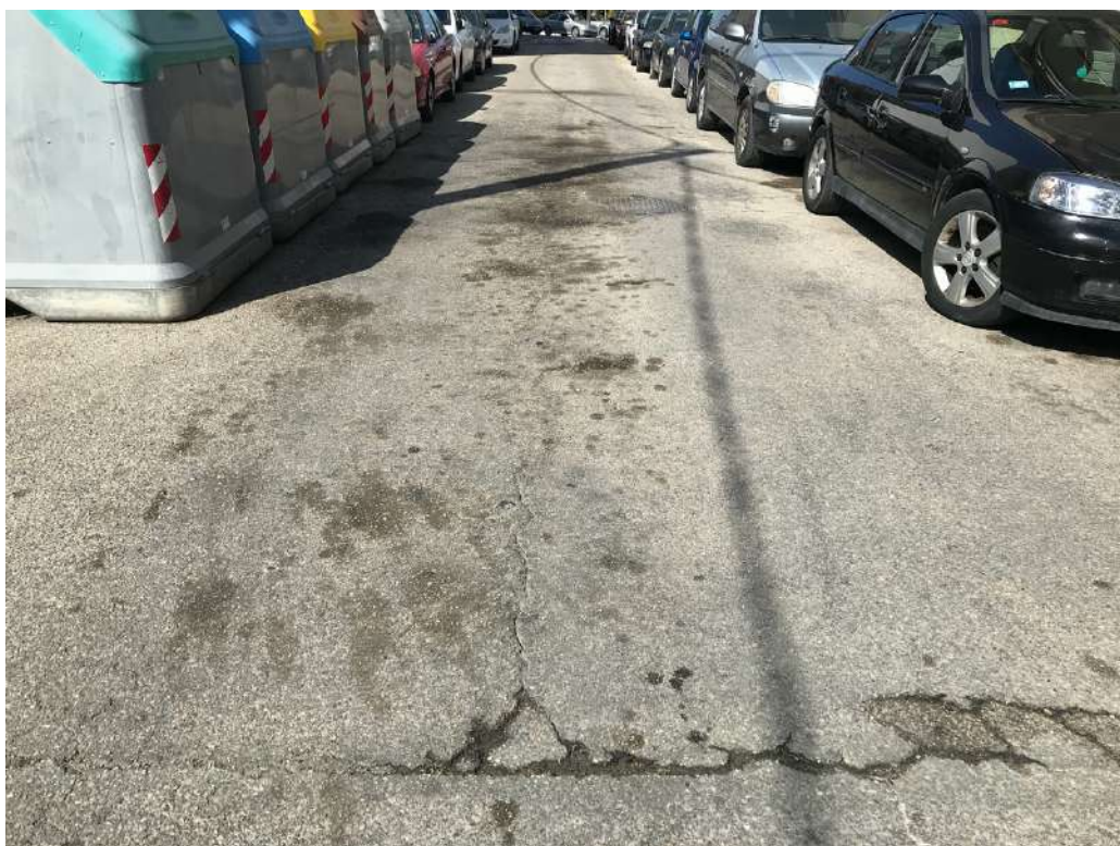
Asfalt malmès al carrer Juan de la Cierva
