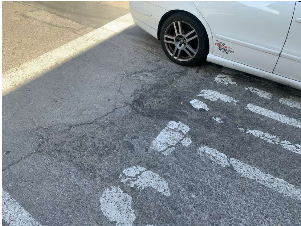
Asfalt malmès al carrer Francisco de Vitoria
