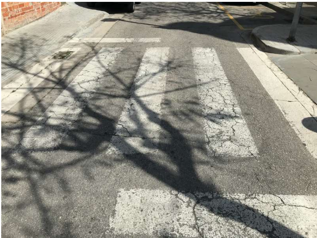
Asfalt malmès al carrer Sagunt
