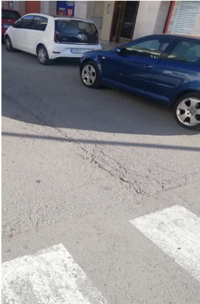
Asfalt malmès carrer Ildefons Cerdà
