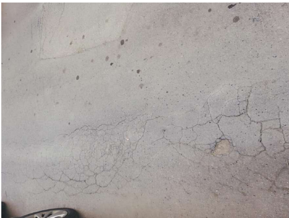
Asfalt malmès carrer Torreta
