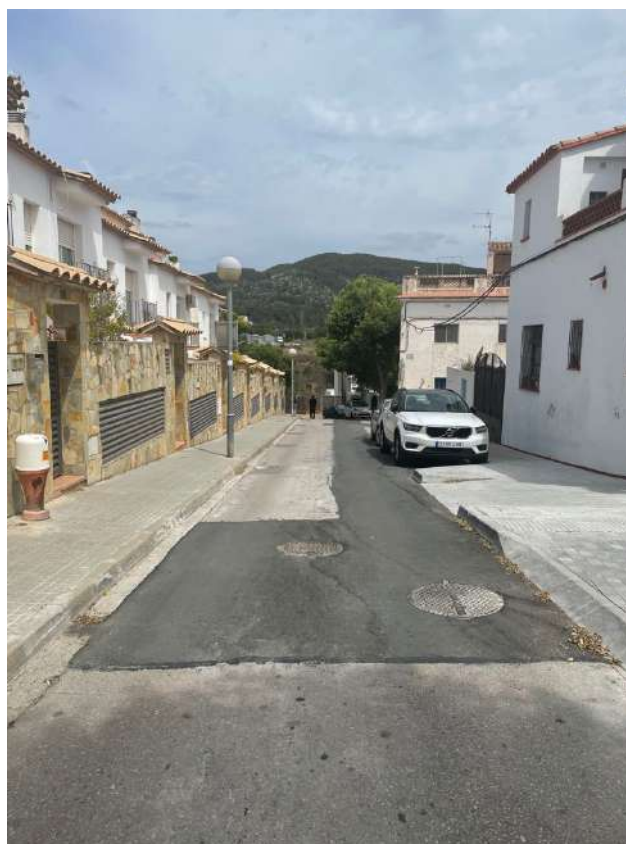
Estat de conservació d l'asfalt amb reparacions
