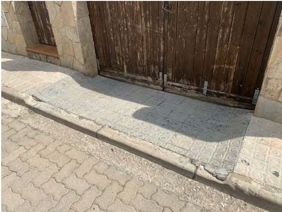
Discontinuitat a vorera amb pendent no normativa
