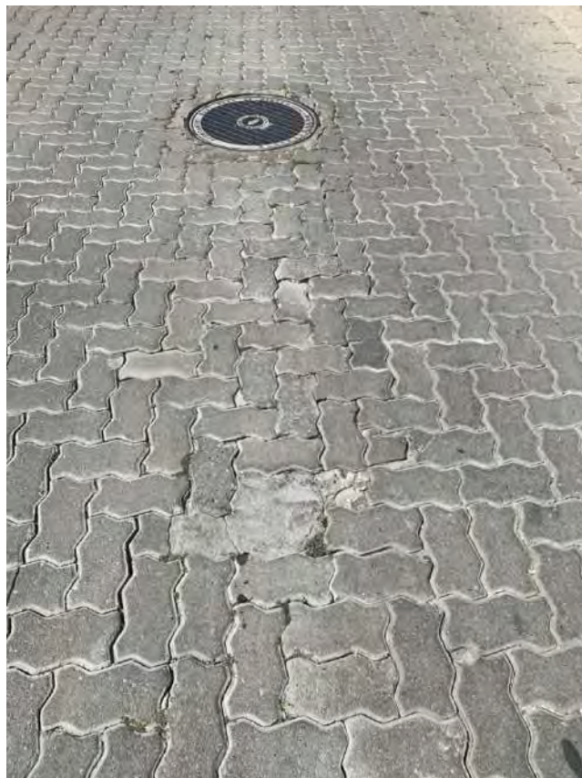
Patologies al paviment de llambordes
