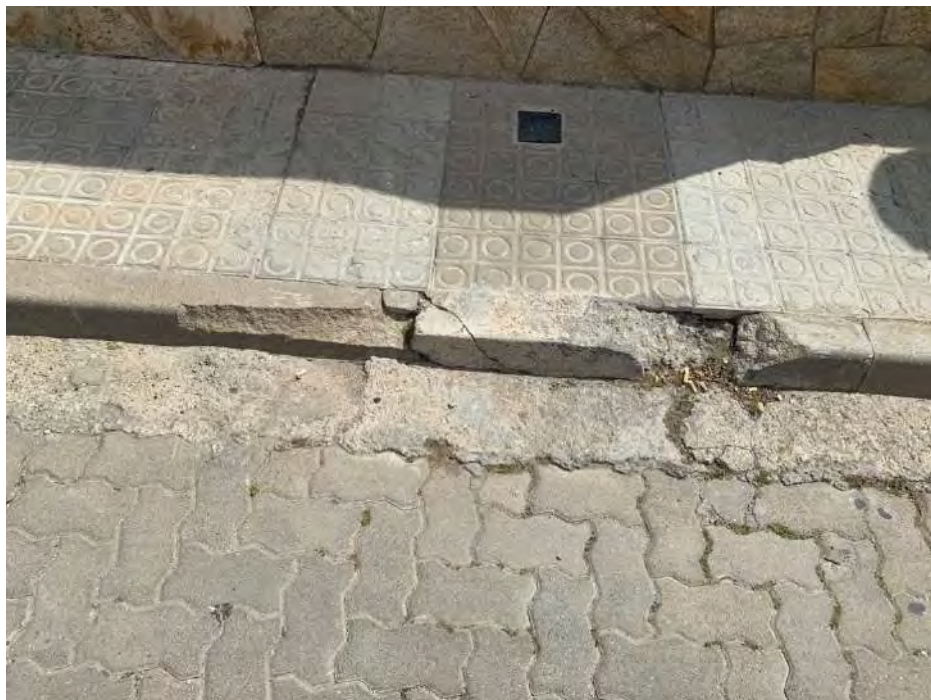
Deficiències al bordó de vorera est
