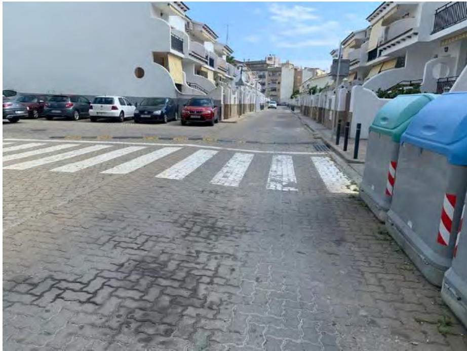
Patologies al paviment de llambordes
