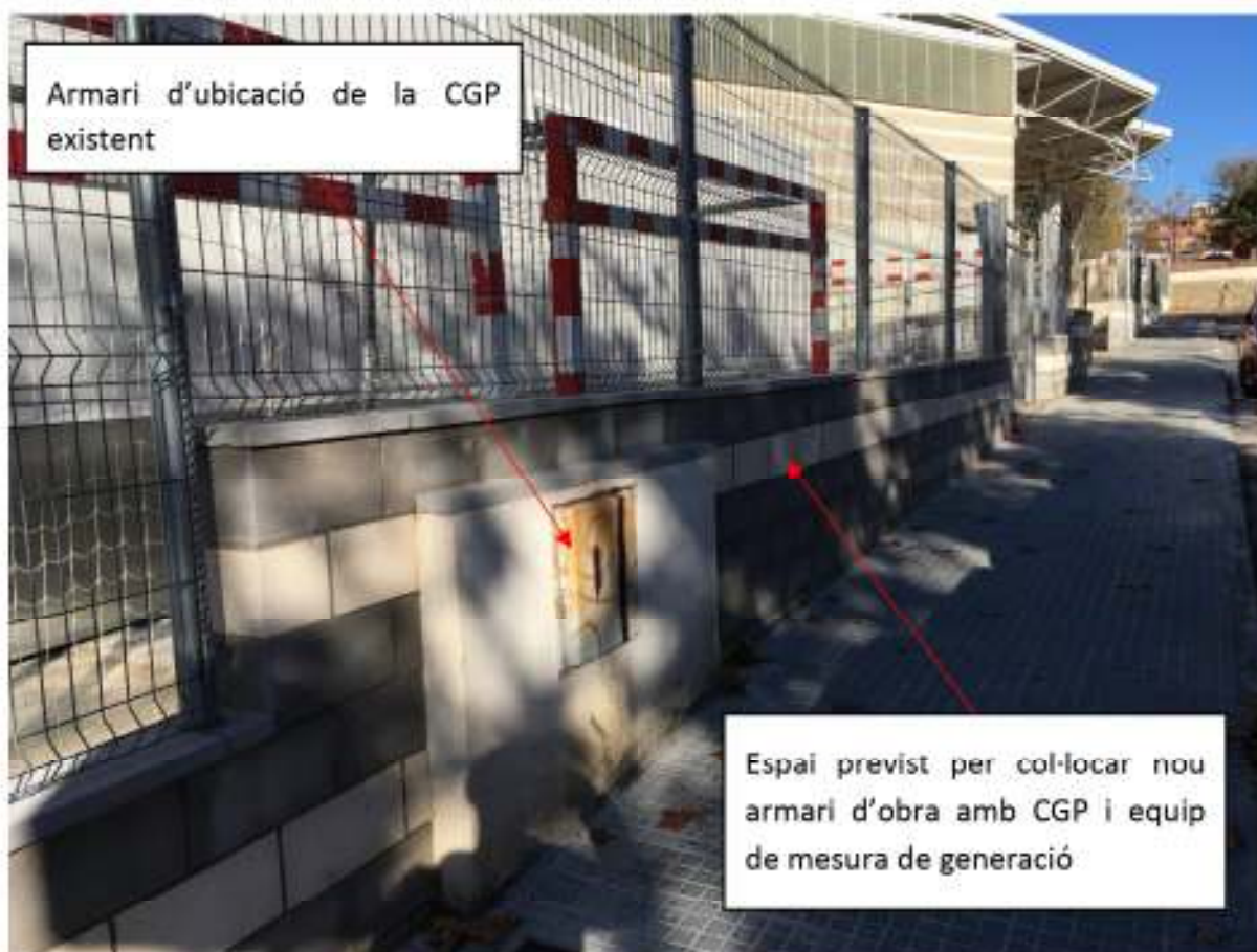
Figura 10: Instal·lació d'enllaç existent al Pavelló de Ribes. Font: elaboració pròpia.
