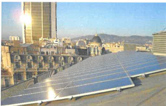
Edifici Can Serra, Hospitalet de Llobregat (Barcelona) – 16,2 kWp
