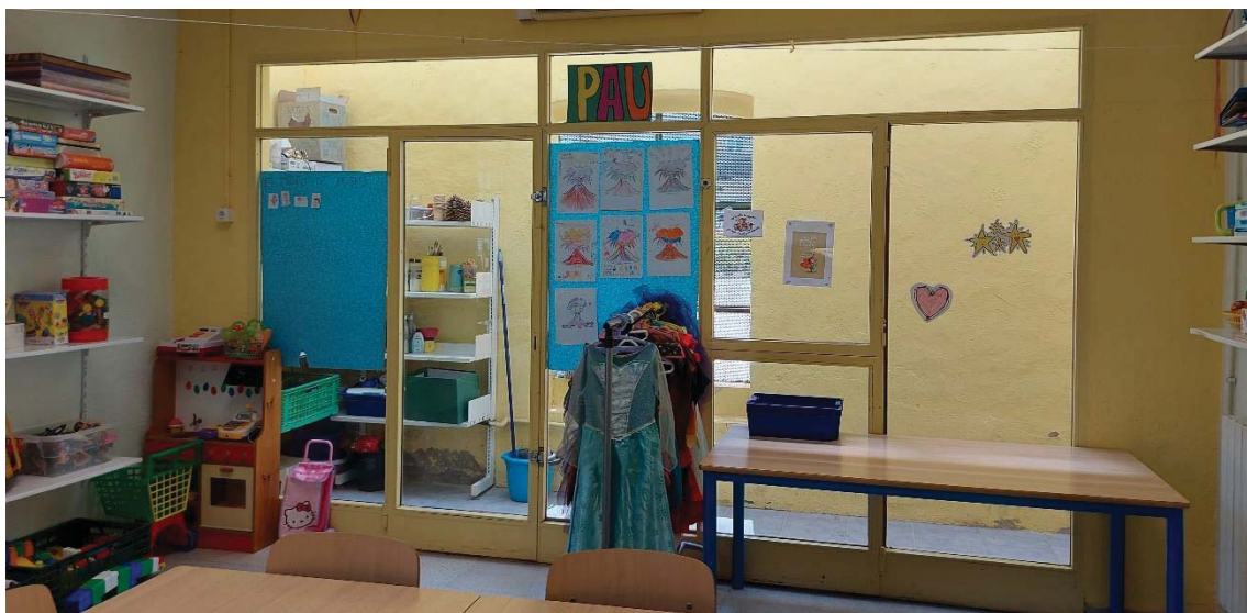
Algunes de les obertures a substituir
