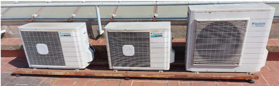
Equips de climatització actuals
