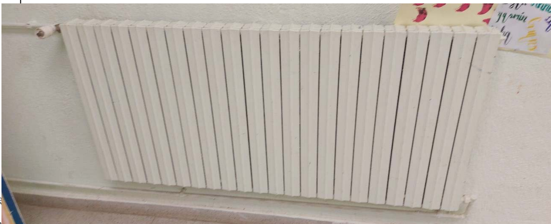
Sistema de calefacció
