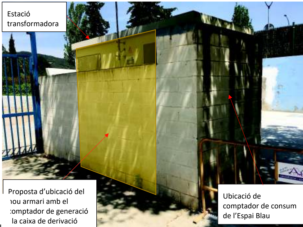
Figura 9. Instal·lació d'enllaç existent a l'Espai Blau. Font: elaboració pròpia.
