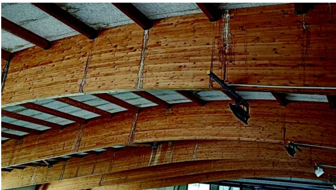
Vista en detall de les humitats existents a les bigues principals degudes a condensacions i/o filtracions des- de la coberta superior
