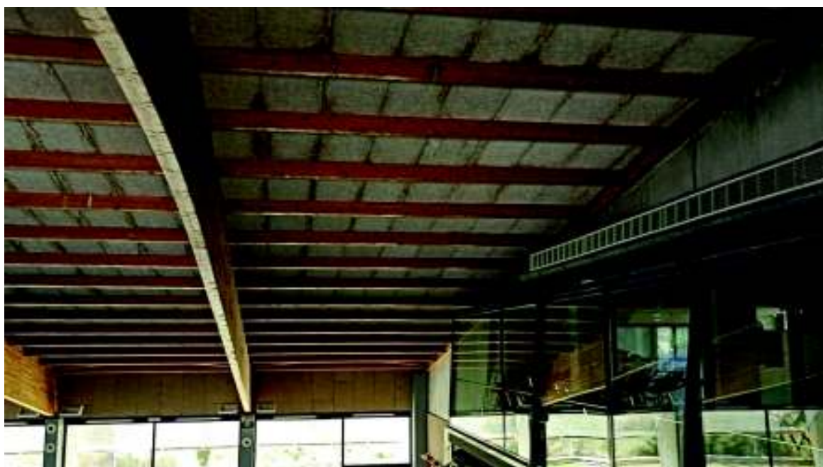
Vista en detall de les humitats existents a les corretges degudes a condensacions i/o filtracions des- de la coberta superior
