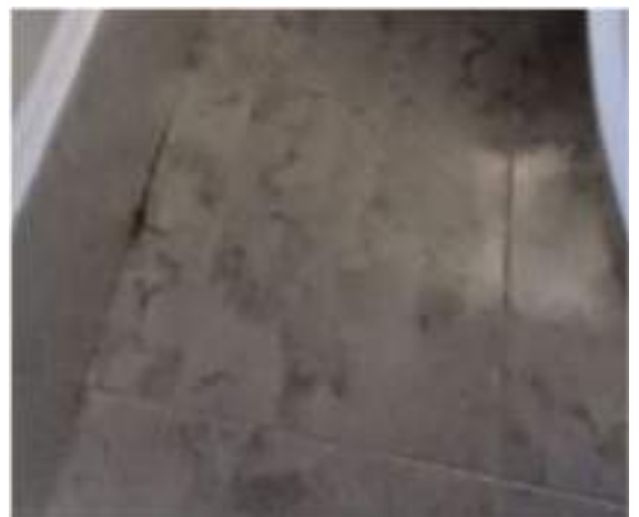
Paviment a bany de planta baixa
