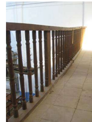
F3- FORJAT DEFORMAT
