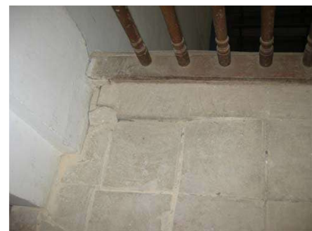
F4- PAVIMENT ENFONSAT
