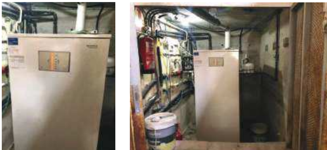
Figures 4 i 5: Caldera i sala de caldera
