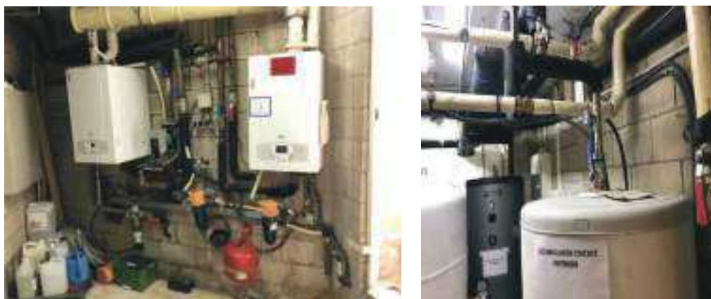
Figura 6:i 7 Calderes i sala dels acumuladors
