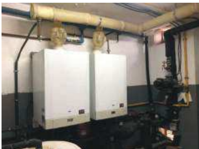
Figura 3: calderes de la sala tècnica
