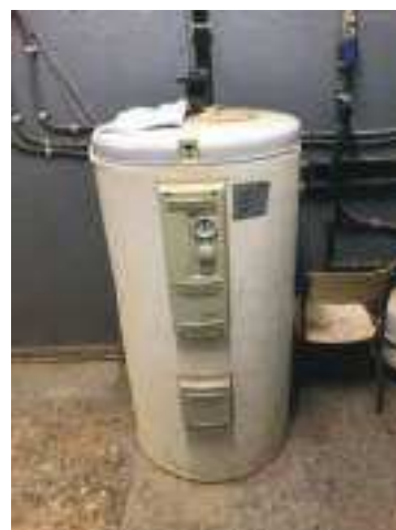
Figura 2: Acumulador de la sala tècnica
