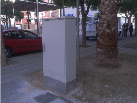
Quadre de comandament i protecció nº 17: Pl. Llobregat
