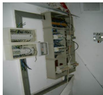
Quadre elèctric general
