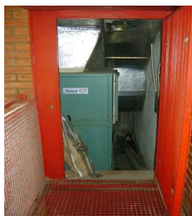
Sala de bomba de calor
