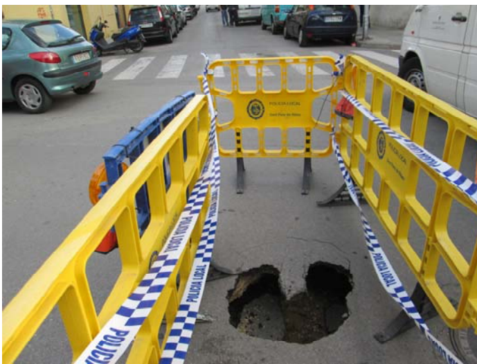
Furat a l'asfalt
