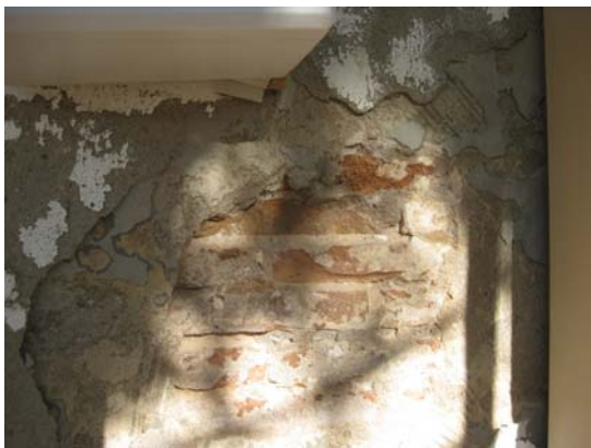
Cala a la façana posterior
