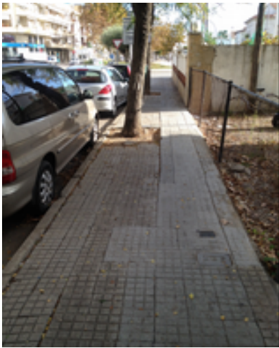
Deficiències en el paviment de panot
