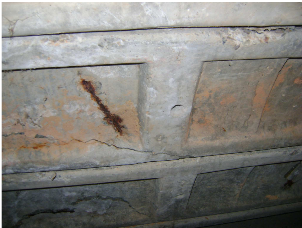
Estat actual del sostre de l'espai confinat.
