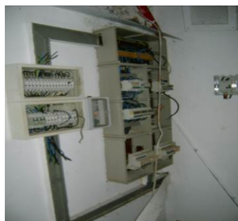
Quadre elèctric general
