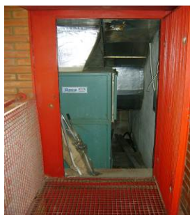
Sala de bomba de calor
