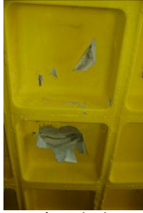
Cassetó amb despreniment pintura
