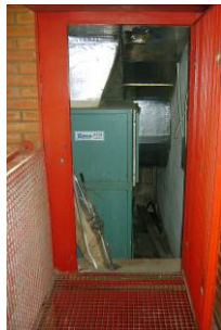
Bomba de calor
