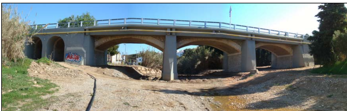
Foto núm. 2. Composició panoràmica del pont de la carretera C246a vist des d'aigua avall
